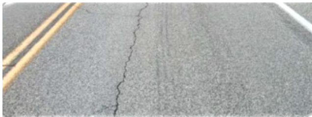
Exemple de fissures Alligator A
